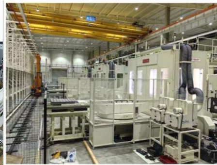
▲マシニングセンター・自動搬送装置
